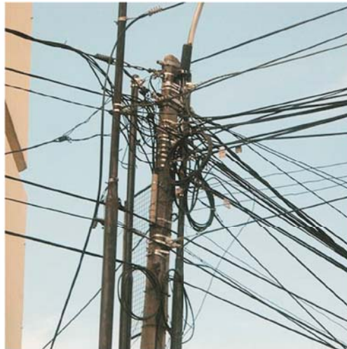
Gambar 13. Banyak kabel telekomunikasi pada tiang (Arman, 2008)
